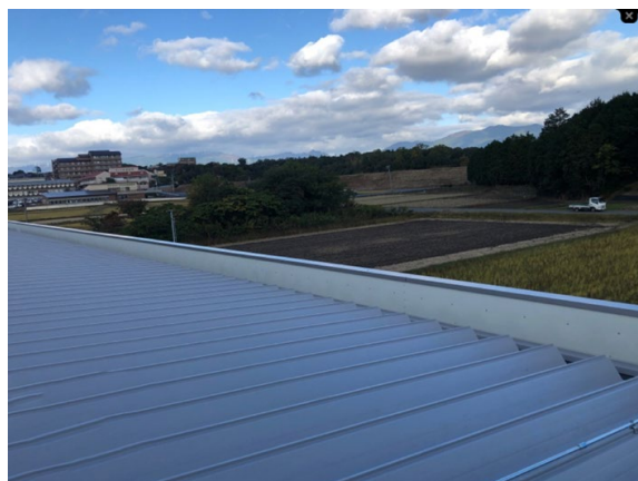
▲倉庫の新築時に鳩除け対策として電気ショックを設置
